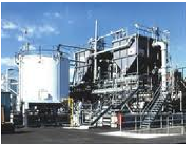
Sistemi ausiliari per la rimozione del surnatante flottato.
